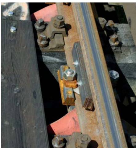
Abb. 9: Seitliche Sylomerunterlagen arbeiten sich heraus
