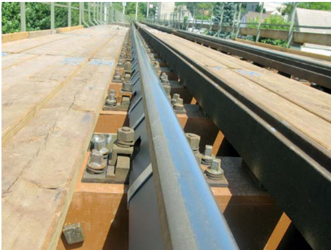
Abb. 3: CalmRail im Bereich Eisenbahnbrücke mit offener Stahlstruktur
